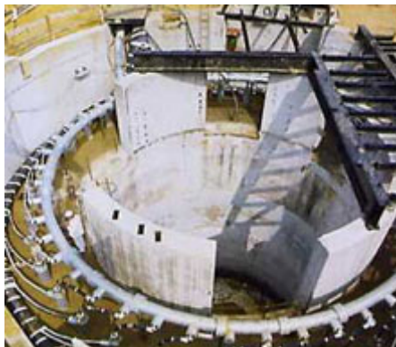
Hệ thống đóng băng miệng giếng
